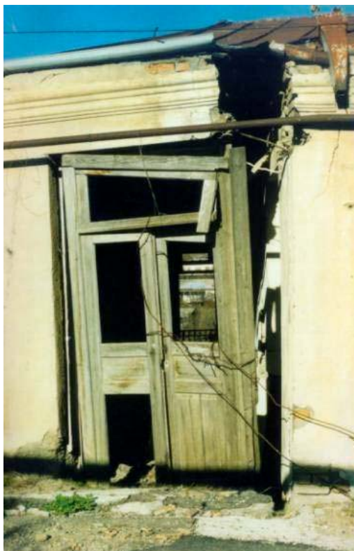
Рис. 4. Полностью деформированное оползневыми процессами жилое здание в г. Сигнахи (фото Г.З. Чангашвили)
